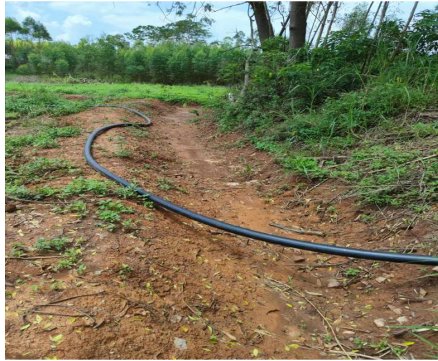
现有沼液消纳管及场外截水沟
